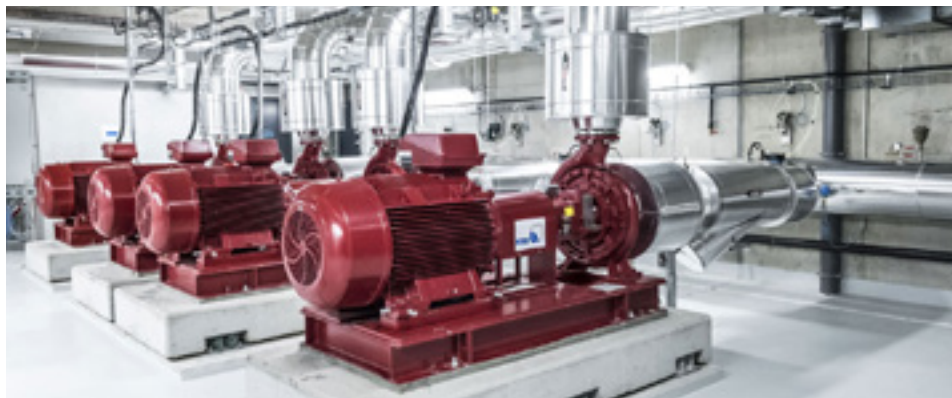
À Marseille, le projet Thassalia alimente en chaud et en froid 600 000 mètres carrés de bâtiments grâce à de l'eau de mer.
