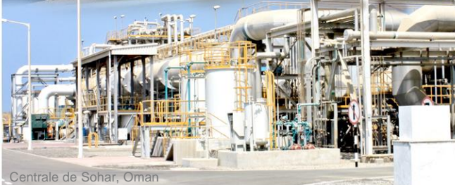
Centrale de Sohar, Oman
