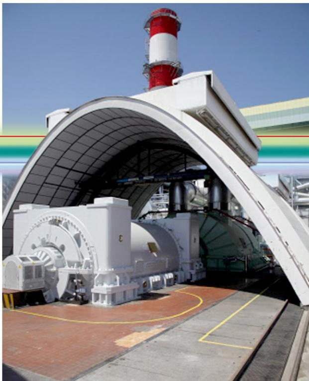
Dunamenti, Hongrie, CCGT
