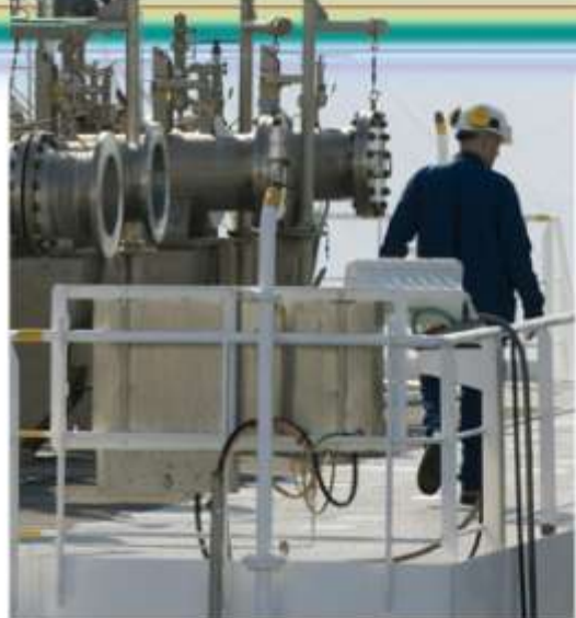
Provalys LNG tanker, Montoir, France
